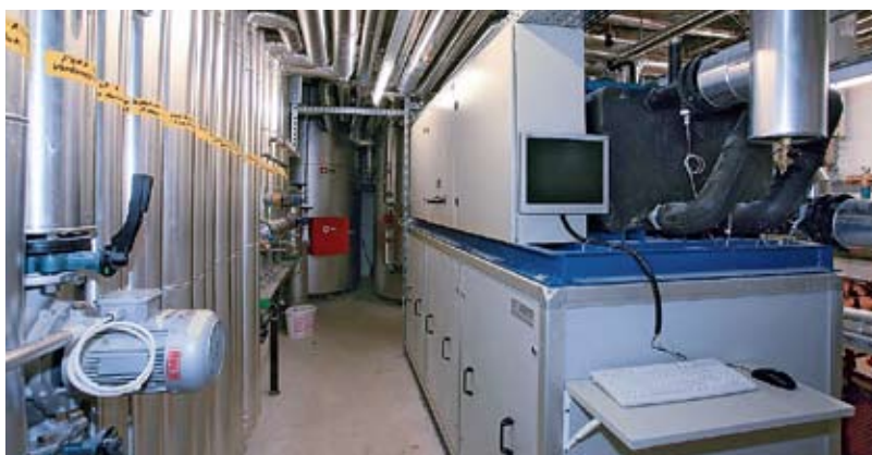
Een KWT afvalwater-warmtepomp van 150 kW voor sanitair waterverwarming.
