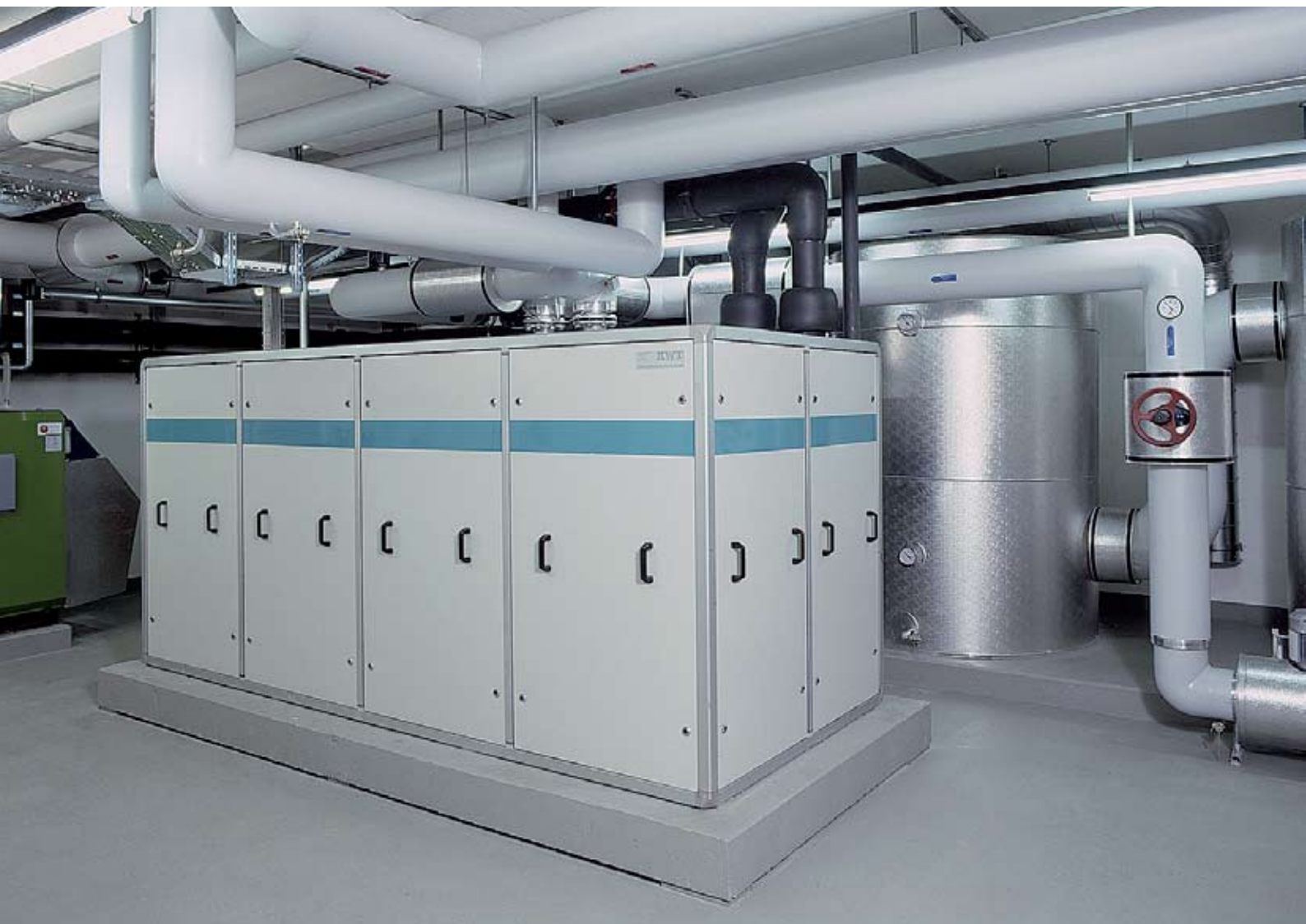
KWT grond/water-warmtepomp met een verwarmingsvermogen van 290 kW
