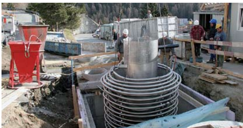
Deze FEKA afvalwaterschacht dient als primaire bron voor de warmwaterbereiding.
