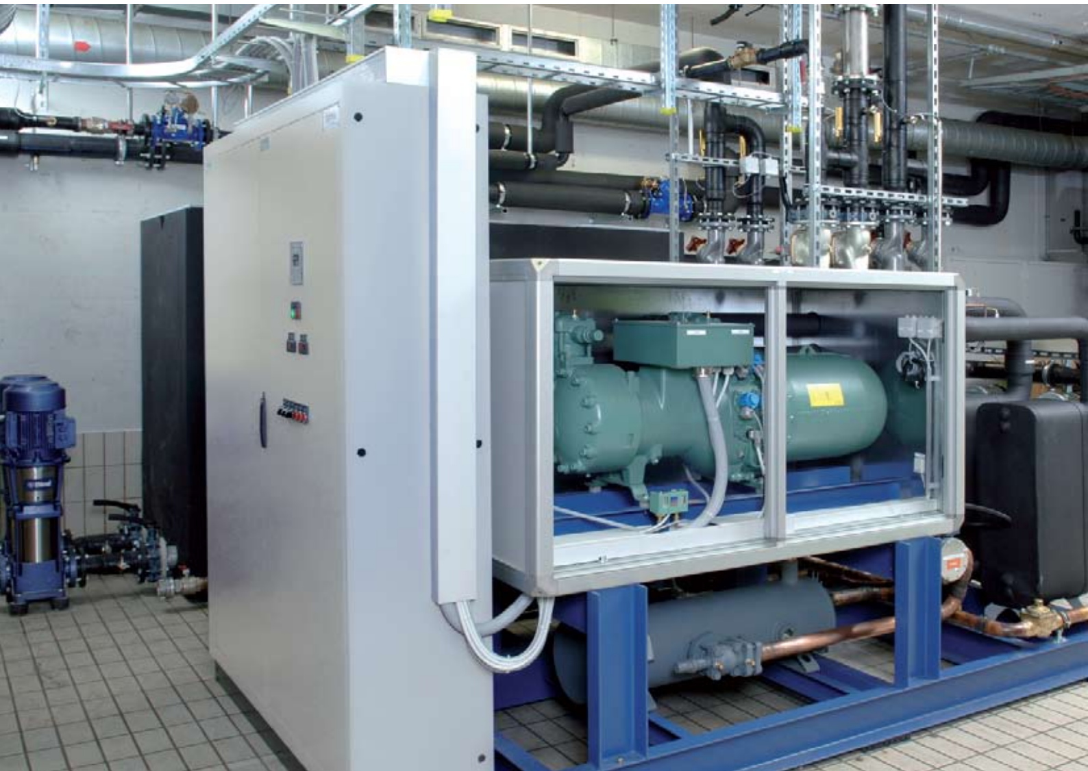
Benutting van restwarmte uit een productieproces met twee KWT warmtepompen van elk 400 kW.
