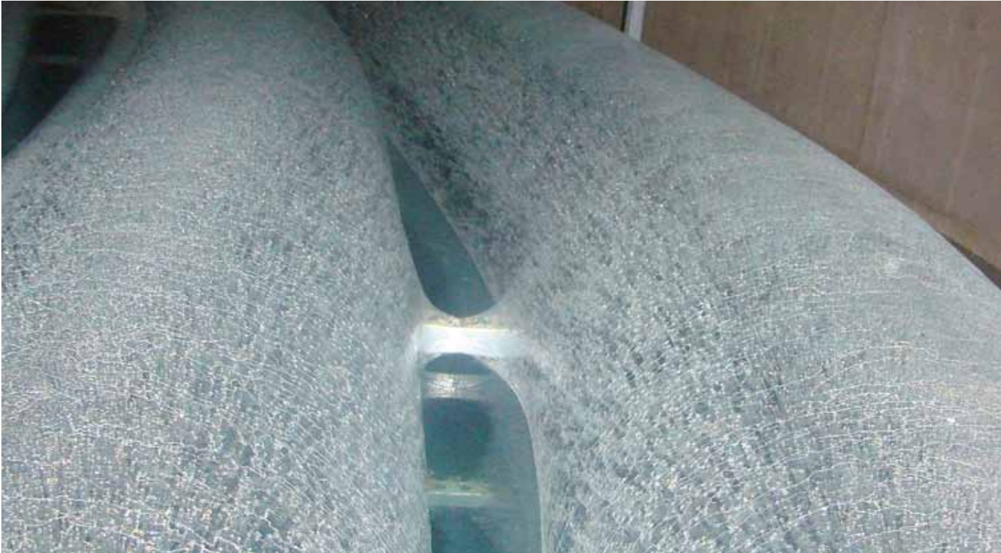
Ijsvorming rond de warmtewisselaar in het ijsreservoir
